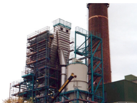
Rauchgasreinigung Schering AG
