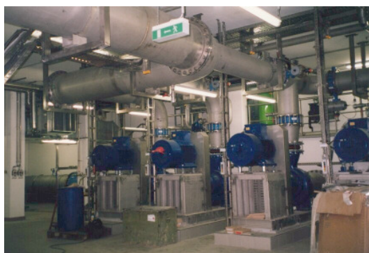
Rohrleitungen Kläranlage Wiesbaden
